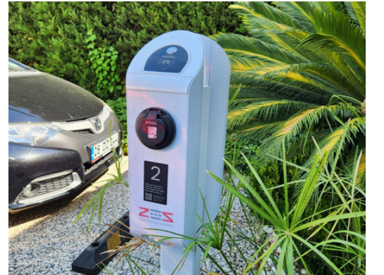
Şekil 3. Elektrikli Araç Şarj İstasyonu
