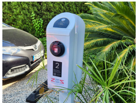
Станция зарядки электромобилей
