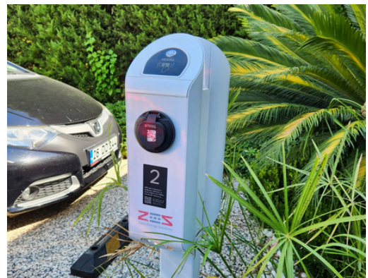
Ladestation für Elektrofahrzeuge
